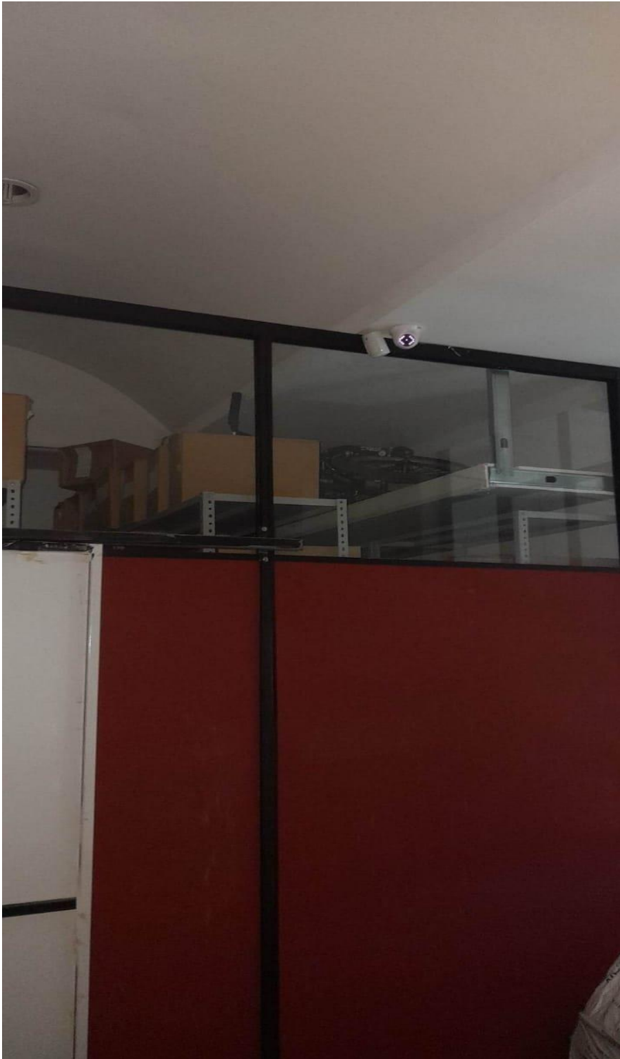
Se evidencia seguridad en las puertas de los depósitos.
